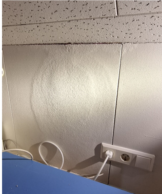
MYND 6 Rakaskemmdir í veggjaplötum vegna leka frá þaki.
