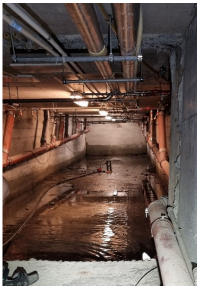
MYND 9 Leki í kjallara utanfrá, líklega vegna skorts á drenlögnum og regnvatnslögnum.
