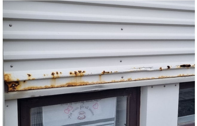
MYND 2 Klæðning illa farin á húsi vegna rakaálags.
